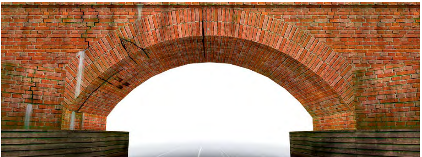
Risse im homogenen Mauerwerk - Sanierung mit mineralischen Füllstoffen | Fissures dans la maçonnerie homogène - Rénovation avec des charges minérales
