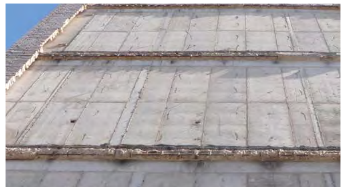
Vormauerschale komplett abgelöst; Drahtanker korrodiert | Mur de parement complètement détachée; ancre métallique corrodée
