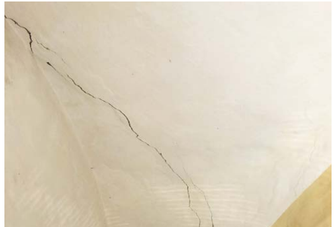
Risse im Gewölbe | Fissures dans la voûte
